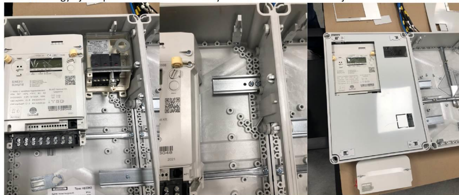
LCR600 HFVK egy új kalapsín beszerelésével elhelyezve. Itt az HFVK adattáblája csak részben leolvasható
